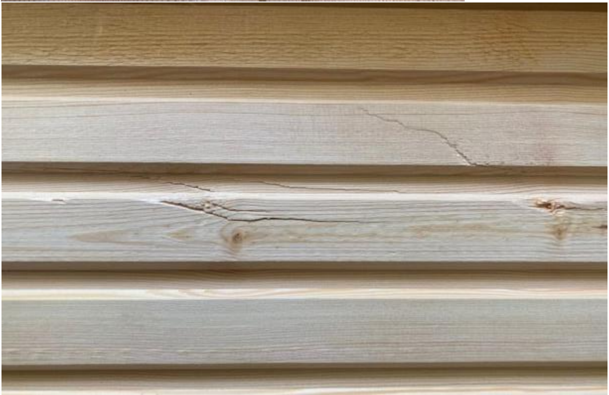
Revner mv på bagsiden
